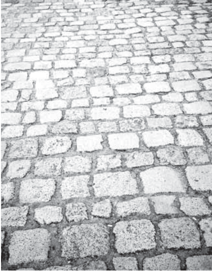
8 – Pavés en granite de Nantes, en bordure de l'Erdre près du tunnel
