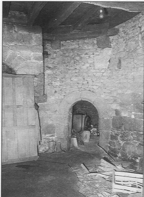
Figure 12 – Coadélan : la porte de communication entre la cuisine et l'ancienne tour en 1987.
