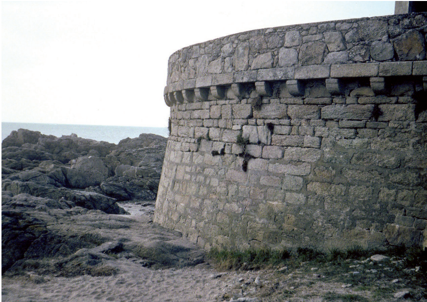
Figure 1 – Batterie de la Barrière, escarpe en arc de cercle (cl. L. Chauris)
